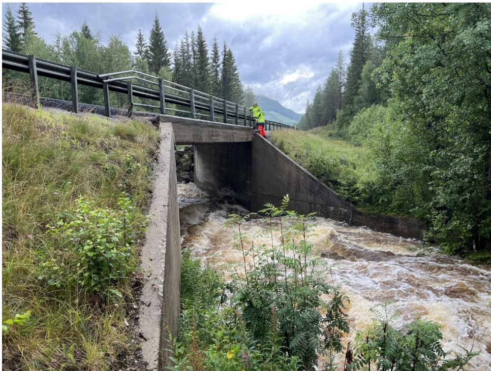
Figur 2-1. Eksisterende veibru ved flom i Søre Bjøråa (Bilde fra SVV)
