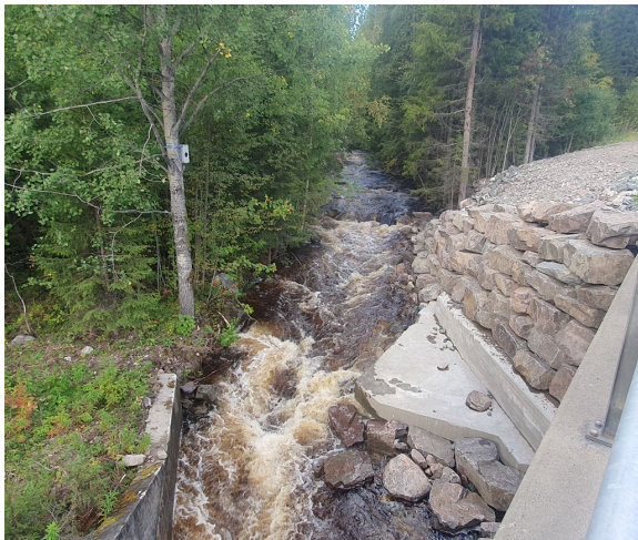
2024-08-30, havarert vinge ligger i elvefaret, er innstøpt og en tørrmur erstatter den.
