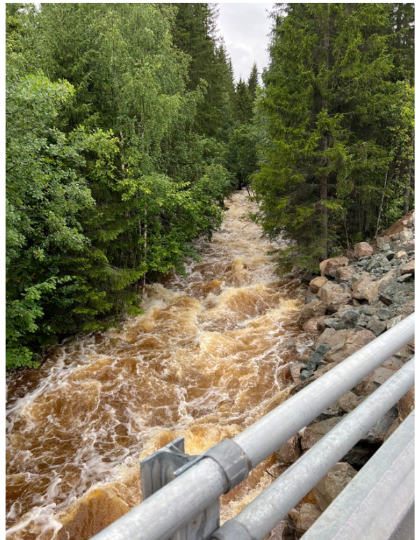
Fra ekstremværet Hans, her har vingen til Søndre Bjørå bru falt ut i elva og en provisorisk steinfylling er under utførelse, 2023-08-09.
