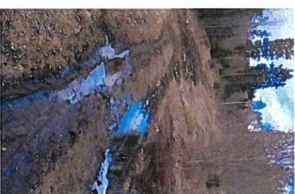
Her var det stort behov for en stikkrenne som fungerte. Foto: Halvor Bergville Andresen.
