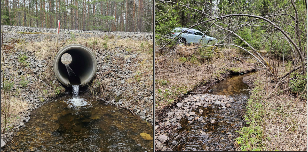
Figur 3-3. Til venstre: vandringshinder for fisk gjennom stikkrenne under jernbanen. Til høyre: deler av fyllingen ligger i bekkeløpet. Foto: Johanna Skrutvold, 29.04.2025.
